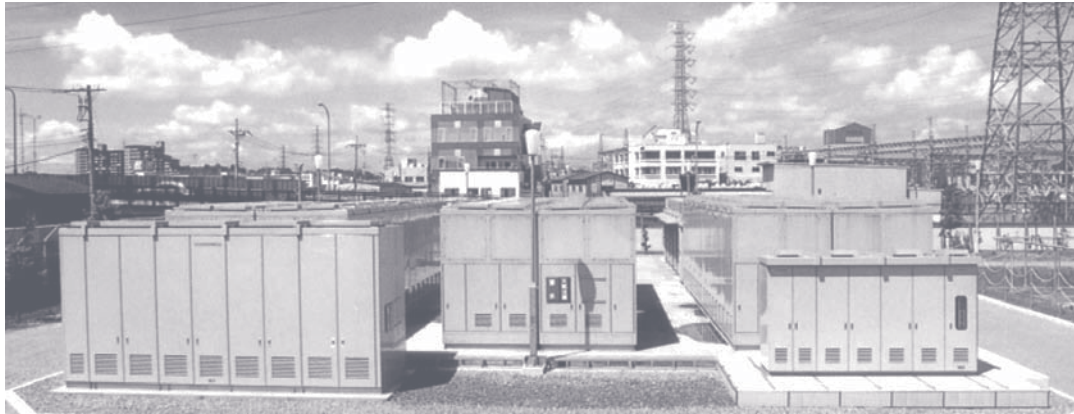
NATRIUM-SCHWEFEL-HOCHTEMPERATURBATTERIE FÜR DEN SOGENANTEN LOAD-LEVELLING-BETRIEB
