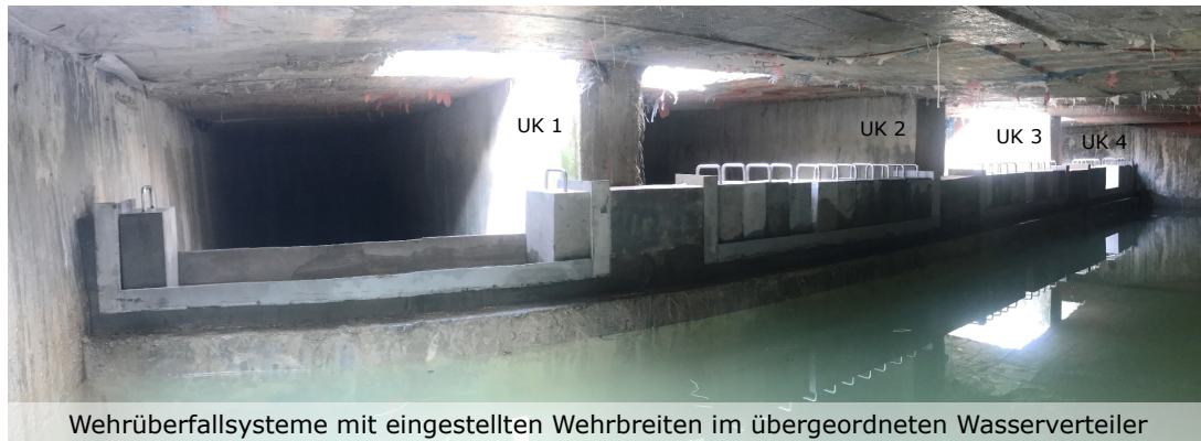
Abbildung 7.16: Wehrüberfallsysteme im übergeordneten Wasserverteiler
