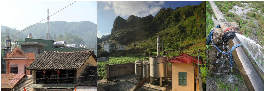
Abbildung 6.7: Private Dachbehälter (links), Förderanlage To Nam (Mitte) und Wasserverlust im Leitungsnetz (rechts)
