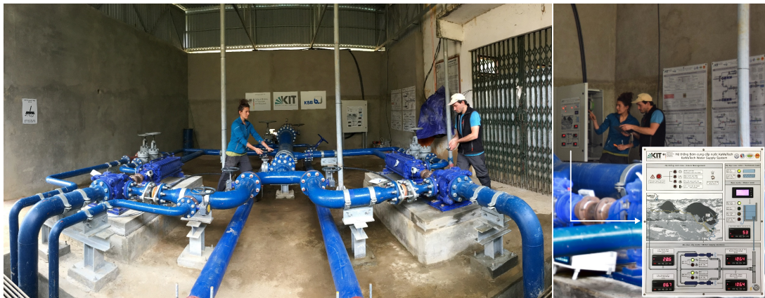
Abbildung 7.5: Betriebstest der Förderanlage und des Monitoring- und Alarmsystems
