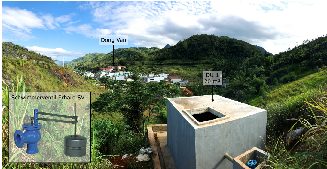
Abbildung 7.19: Druckunterbrecher DU 1 oberhalb der Distrikthauptstadt Dong Van
