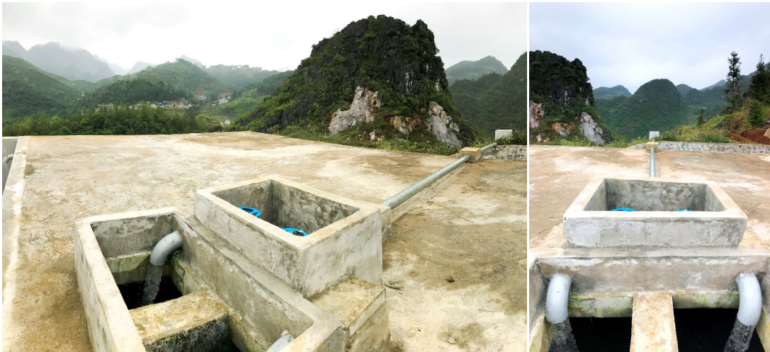
Abbildung 7.26: Zufluss in den Wasserspeicher WS 1
