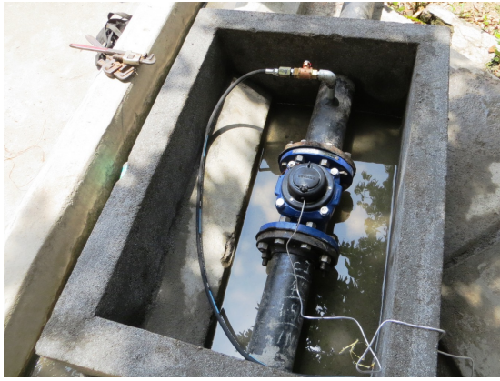
Abbildung 6.7: Woltmannzähler am Zulauf des THESR
