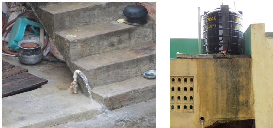
Abbildung 6.25: Wasserverschwendung durch geöffneten Hahn (links) und Tanküberlauf (rechts)
