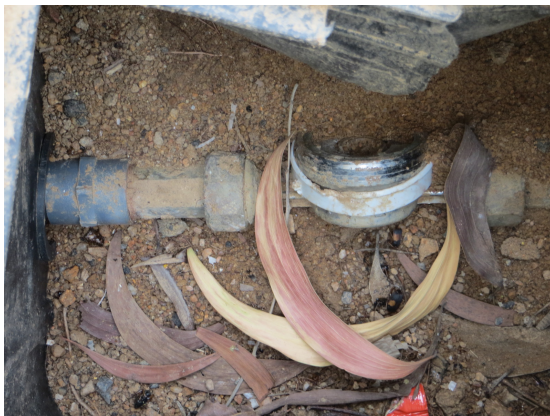
Abbildung 6.13: Zerstörter Wasserzähler aufgrund Verkehrslast
