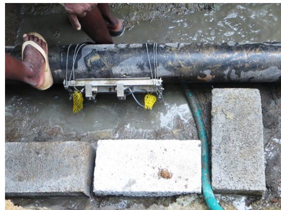
Abbildung 6.10: Messsensoren an der AOL-Leitung
