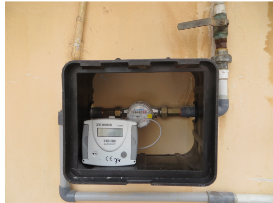
Abbildung 6.12: Wasserzähler inkl. Datenlogger am Auslauf eines Dachtanks
