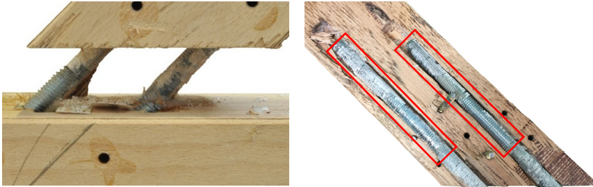
Bild 6-5: links : Versagter Zuganschluss des Trägers Gewi_opt-1. rechts : Aufgetrennte Zugstrebe mit erkennbarer Fehlverklebung (rot markiert).
