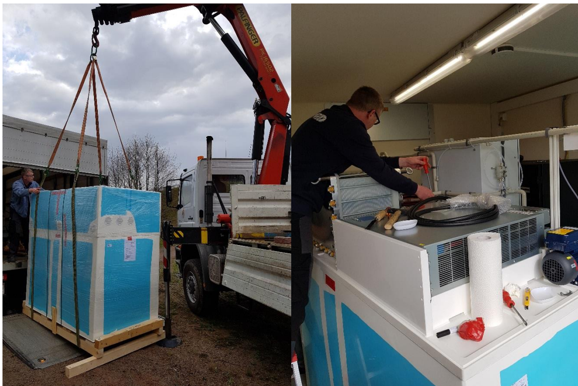
Bild 10: Lieferung und Inbetriebnahme der VRFB durch die Firma SCHMID
