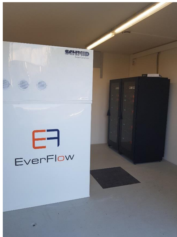
Bild 13: Blick in den Batterieraum
