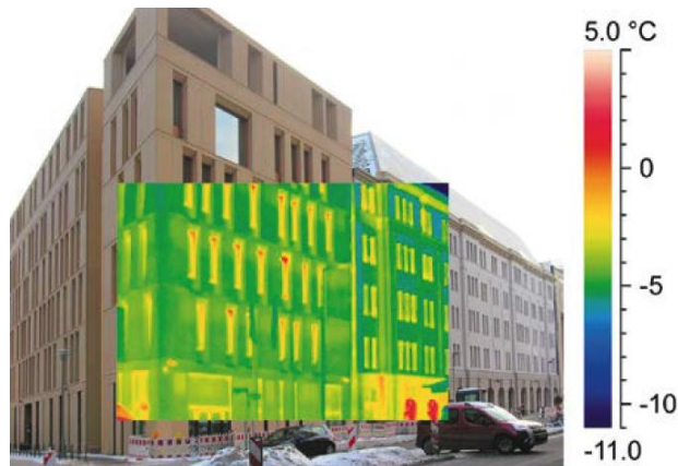
Abbildung 171: Thermografie der Straßenfassade des BMUB in Berlin zur Überprüfung der Ausführungsqualität, Quelle: (BMUB 2016)
