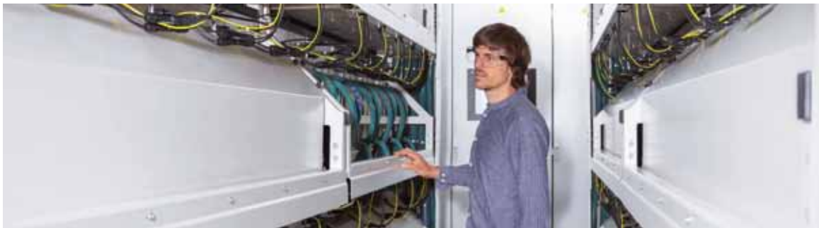
Julian Kirn bei der Sichtprüfung der Anlage, in der die Energiewandlung stattfindet
