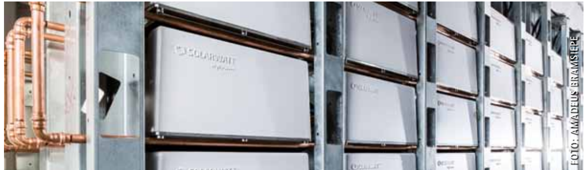
Im Fokus des Lithium-Ionen-Großspeichers steht ein kostenoptimiertes Design mit einem innovativen Kühlkonzept
