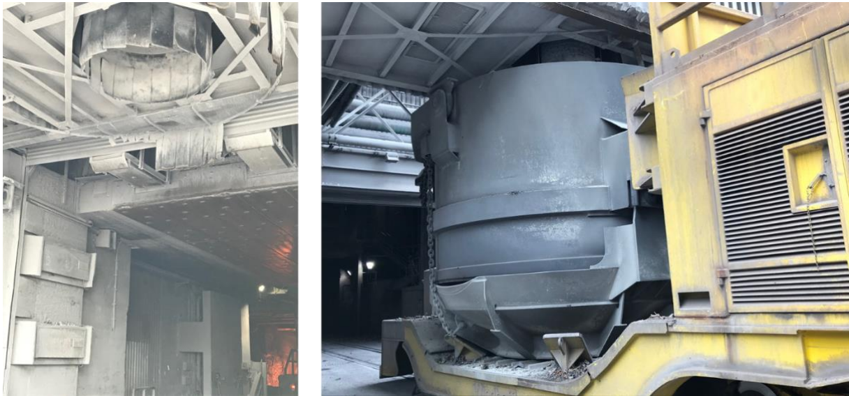
Bild 7 Dosierstation für Chargenkohle mit absenkbarer Rohrleitung (links) und Befüllung des Rangierkorbes mit vollständig in den Korb abgesenkter Leitung (rechts). Quelle: Badische Stahlwerke GmbH.
