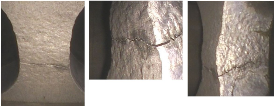
Abbildung 9.6: Stegbereich im eingebauten Zustand nach der TMF/HCF-Prüfung mit F_{a,HCF} = 2,8 kN und überarbeitetem Kühladapter
