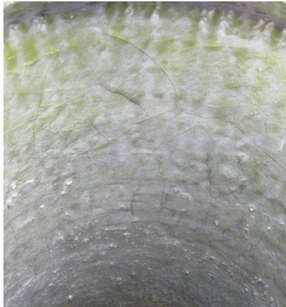
Slag layer on cooling screen
