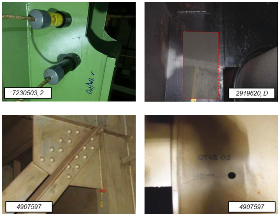
Abbildung 3-5: Exemplarische Risse in Quersteifen von Längsträgern (oben: Kat. 3Ia/b, unten: Kat. 3IIa/b) (Quellen: Koller 2018a; Ungermann et al. 2016)
