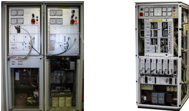
Abbildung 4.23: links: Schaltschrank mit Netzzeitspeisung, Tiefsetzsteller und Drehstrombrücken zur Maschinenversorgung (Foto: Jan Richter), rechts: Schaltschrank des MMPMC (Foto: Alexander Schmitt)
