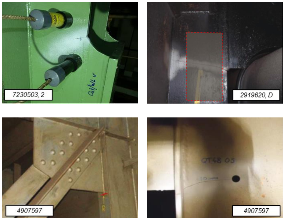
Abbildung 3-5: Exemplarische Risse in Quersteifen von Längsträgern (oben: Kat. 3Ia/b, unten: Kat. 3IIa/b) (Quellen: Koller 2018a; Ungermann et al. 2016)
