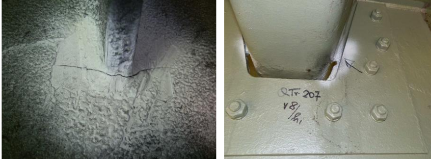
Abbildung 1-1: Reparaturschweißung an einem Fahnenblech mit Folgeriss (links), Aufgelaschtes Blech an einem Querträgersteg einer orthotropen Fahrbahnplatte mit Folgeriss (rechts) ( Koller 2018b)
