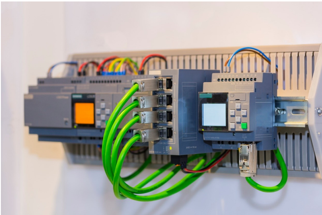
Abb. 4.3 Speicherprogrammierbare Steuerung (SPS)
