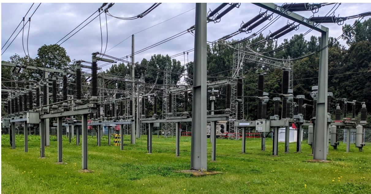
Abbildung 2-4: 110 kV Sammelschienen im Umspannwerk Karlsruhe Ost
