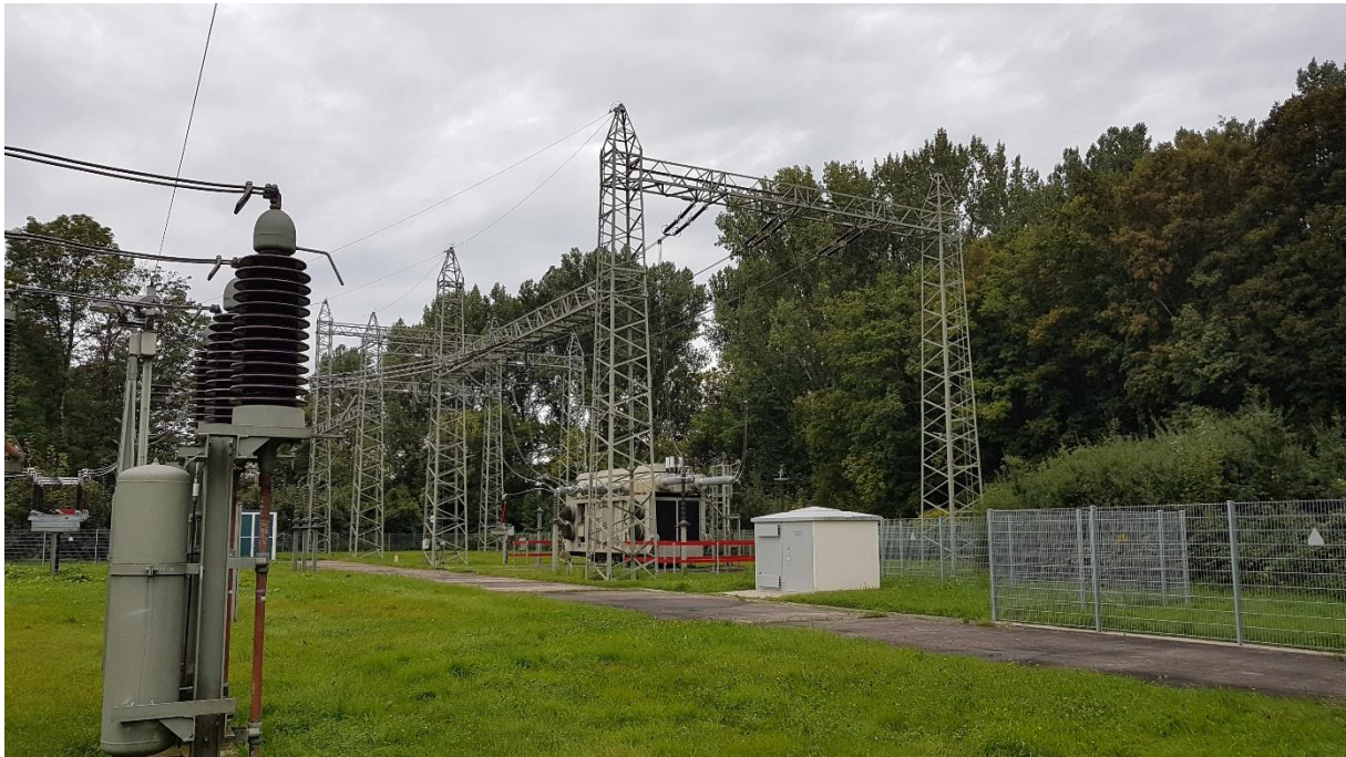
Abbildung 2-2: 220 kV auf 110 kV Transformator im Umspannwerk Karlsruhe Ost
