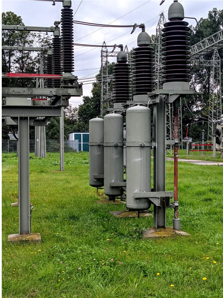
Abbildung 2-5: Die Erdleitung am Ende der 110 kV Sammelschienen
