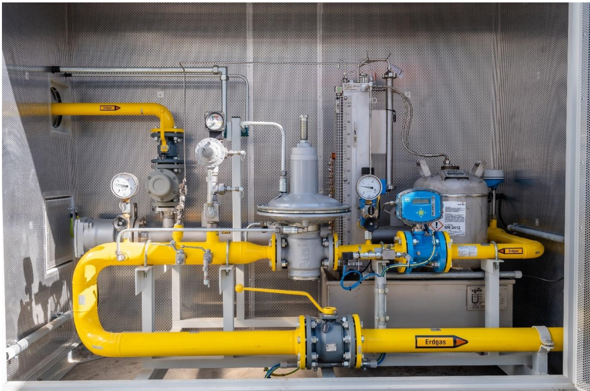
Abbildung 2-7: Gasdruckregelanlage mit Odorierung einer LNG-Anlage (Foto GWI)
