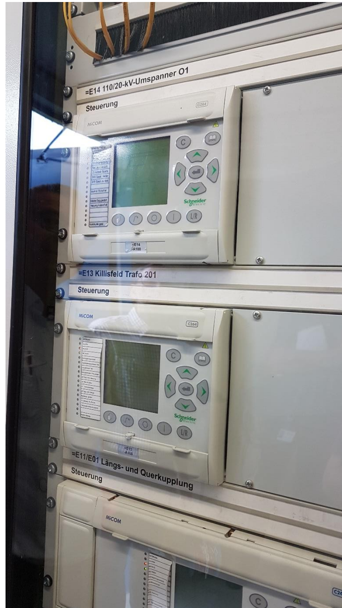
Abbildung 2-3: Feldgeräte (IEDs) von Schneider Electric
