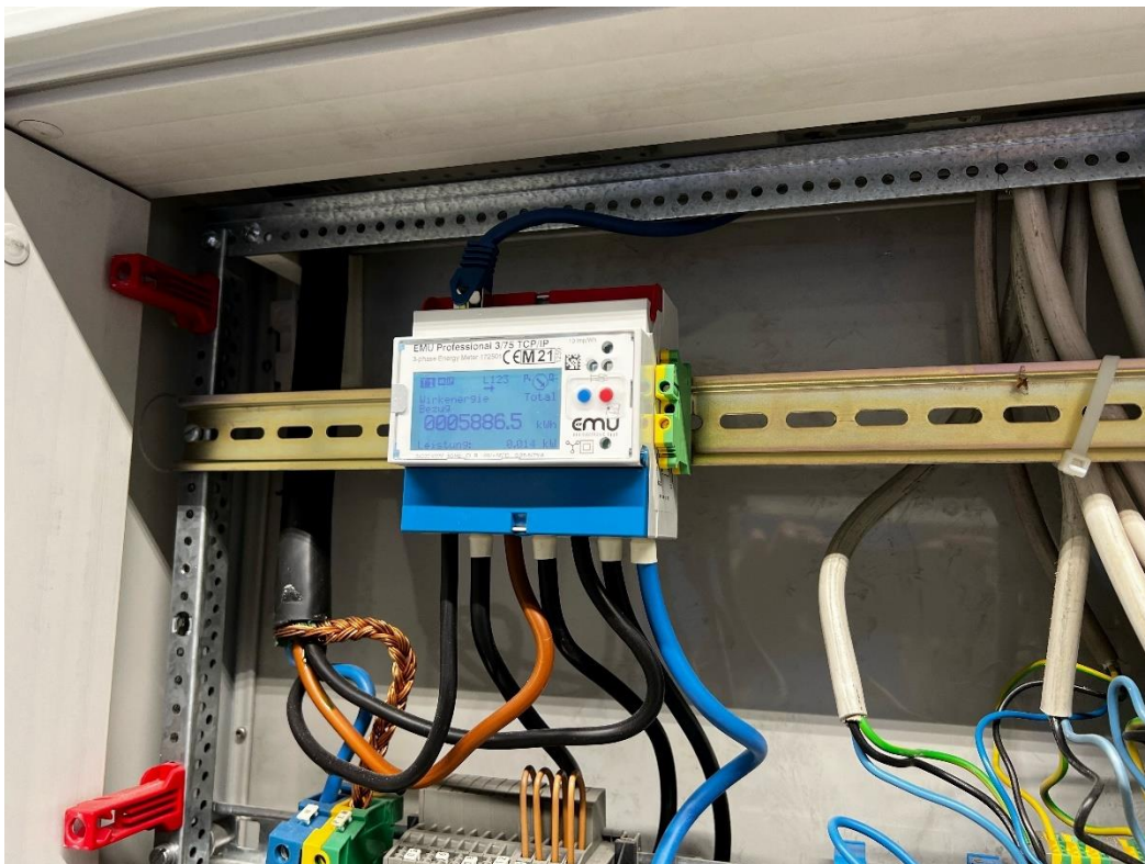
Abbildung 6-2: Stromzähler in einer Unterverteilung (Foto GWI)
