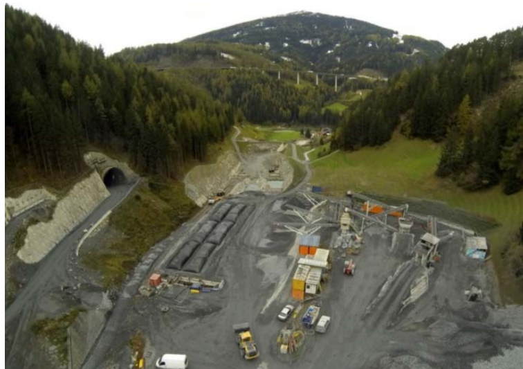
Abb. 5: Übersicht über die Materialaufbereitungsanlage im Padastertal, Foto BBT-SE
