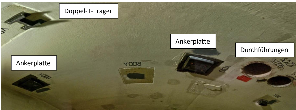
Abbildung 1 : Beispiele für Störobjekte in den Betonoberflächen
