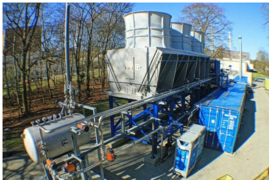
Fig. 3: Propane tank und Condenser
