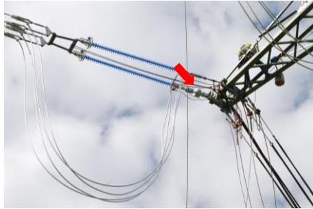
Abbildung 21: Einbau einer Kraftmessdose, zur Aufzeichnung der auf die Isolatoren (durch Pfeil gekennzeichnet) wirkenden, mechanischen Kräfte [119].
