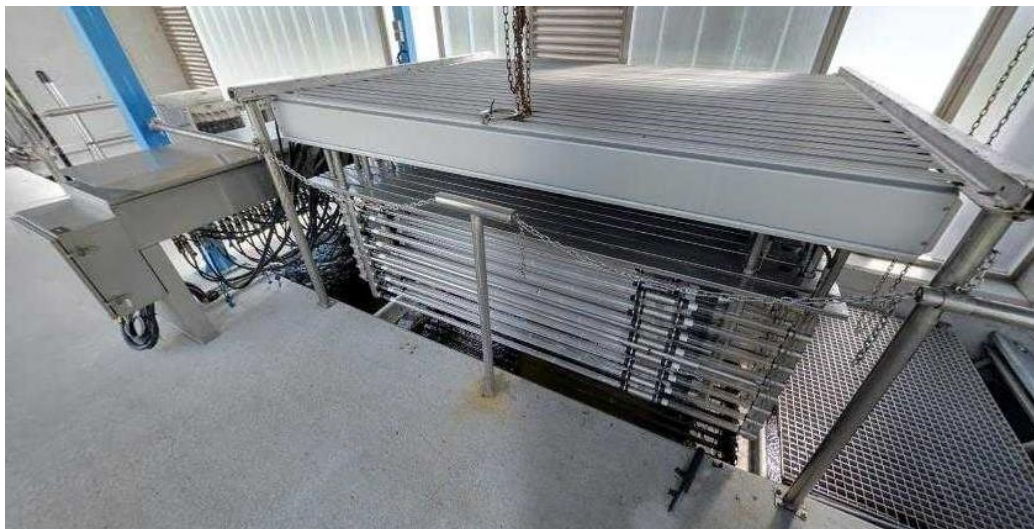
Abbildung 9: Beispiel für den Lampenteil eines Reaktors, in welchem UV-Strahlung zur Behandlung von biologisch gereinigtem Abwasser genutzt wird. Bild mit Erlaubnis von Paredes et al. übernommen [66] .
