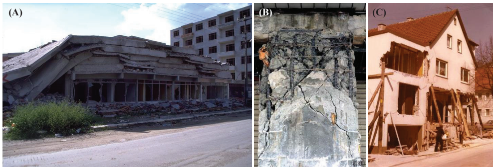
Abbildung IV.8: Beispielfotos sehr starker Schäden – global (A) [134], Stahlbeton (B) [134] und Mauerwerk (C) [55]
