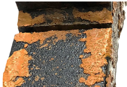
(b) Draufsicht auf den gerissenen Nahtübergang
