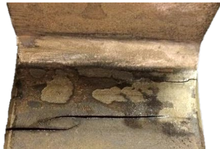
(b) Draufsicht auf den gerissenen Grundwerkstoff
