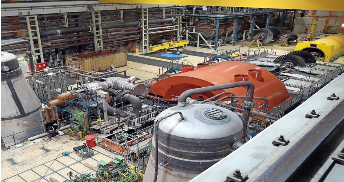
Abbildung 2.6: Rohrleitungen im Maschinenhaus des GKN I [35]
