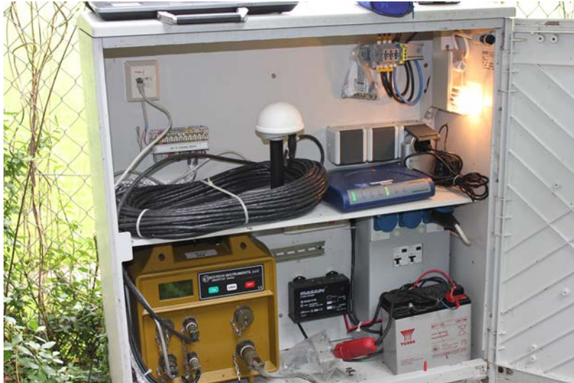
Abbildung 3: Beispiel von einem seismischen obertägigen Gehäuse.
