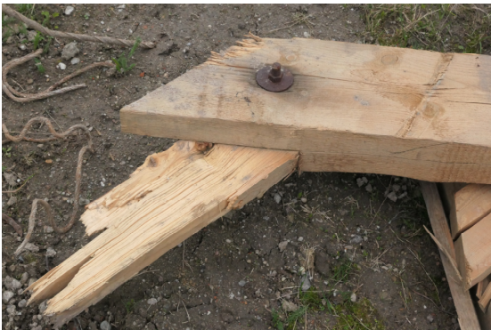
Abb. 8: Ausbauschaden infolge Zerreißen der Verbindung am First
