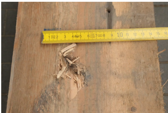
Abb. 12: Ausbauschaden an Kantholz, bei S10 tolerierbar
