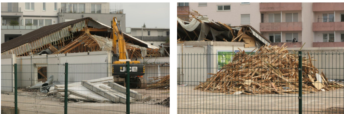
Abbildung 18: Nagelplattenbinder eines Supermarkts (links) und Holzbruch während der Lagerung im Zuge des selektiven Abbruchs (rechts)
