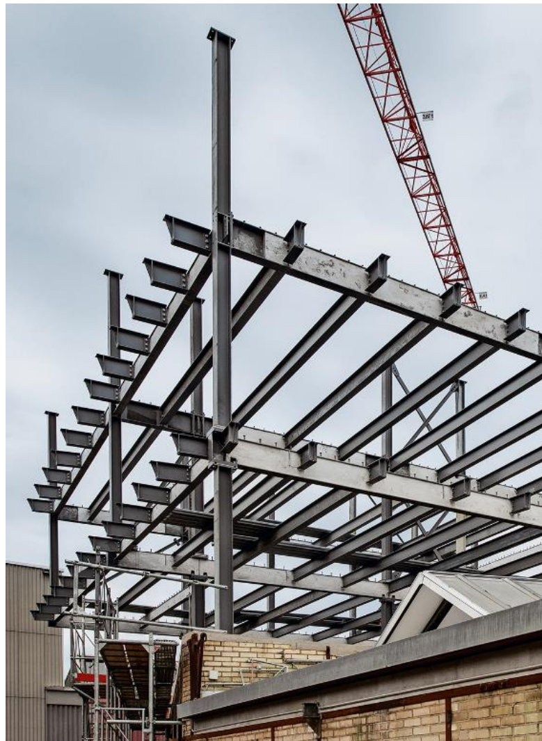
Abbildung 6: Stahlkonstruktion aus wiederverwendeten Stahlträgern zur Aufstockung einer bestehenden Lagerhalle (Quelle: baubüro in situ ag)
