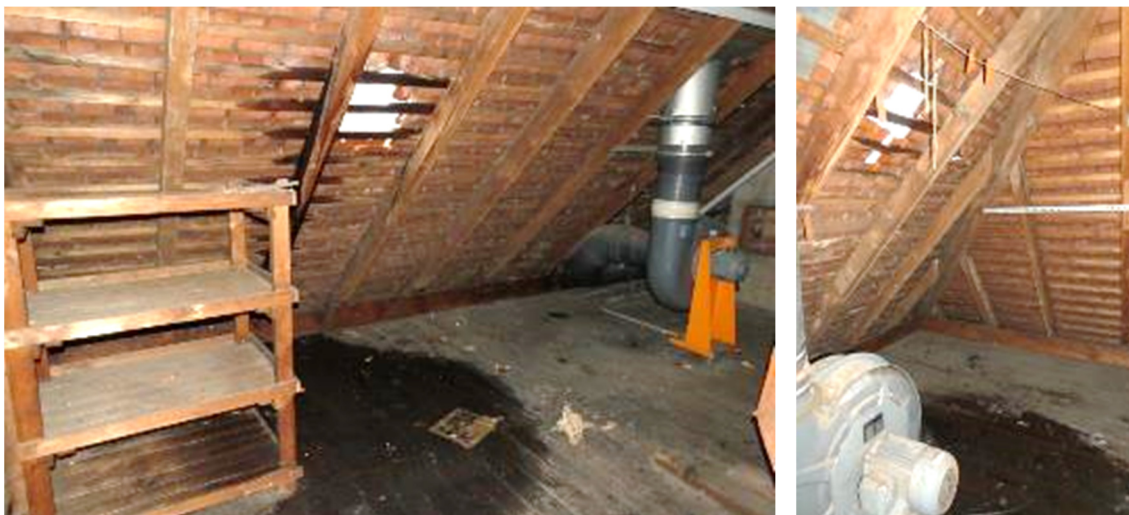
Abbildung 50: Dachwerk eines zum Abbruch bereitstehenden Gebäudes mit Löchern in der Dachdeckung und Zutritt von Regenwasser
