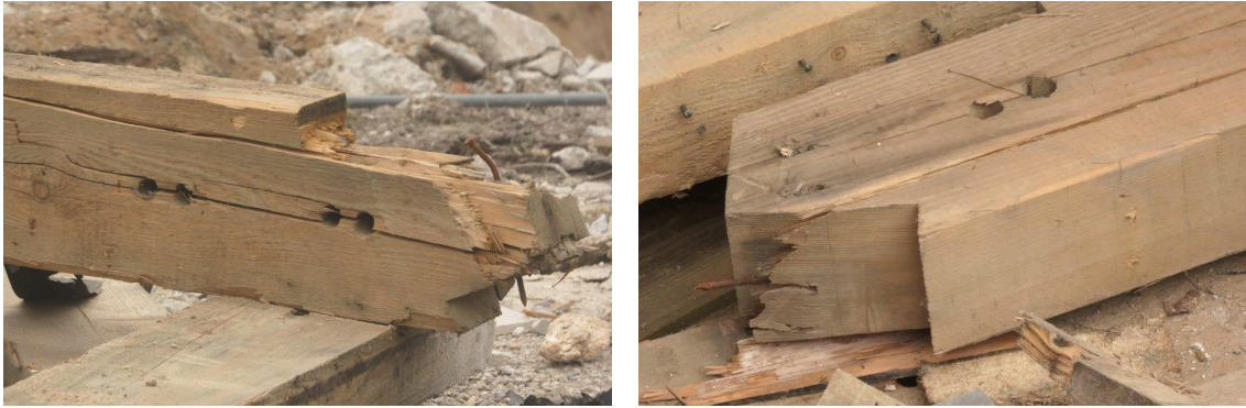
Abbildung 24: Ausbauschäden nach dem Zerreißen der Verbindung am First (oben) und nach dem Abreißen der Winkelverbindung (mit Nagel) am Sparrenfußpunkt (unten)
