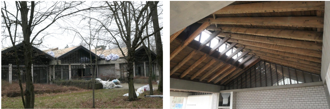
Abbildung 23: Noch stehende Gebäudeteile (links) und Blick unter die Gespärre (rechts)
