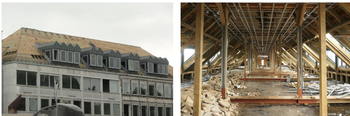
Abbildung 15: Dachwerk (links) und Blick in dessen Inneres (rechts) vor dem selektiven Abbruch
