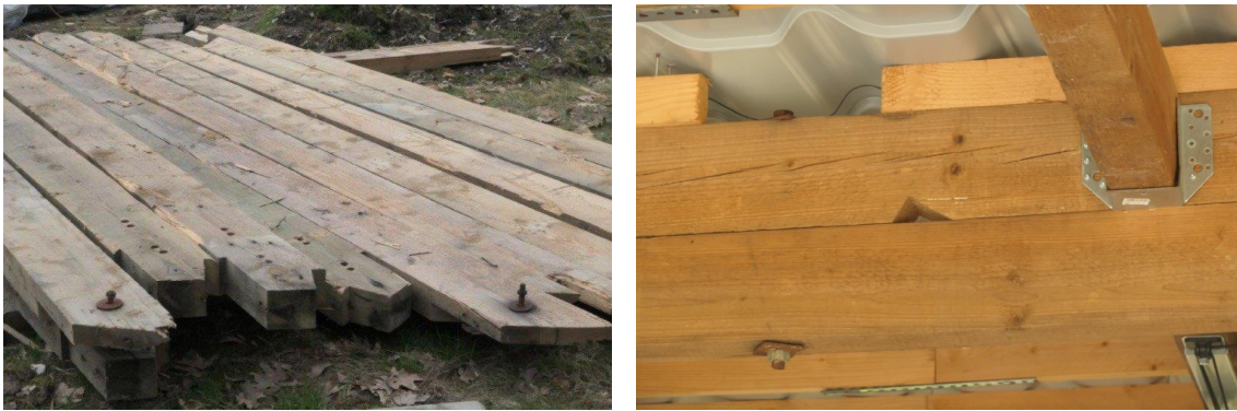
Abbildung 3: Für die Weiterverwendung geborgene Kanthölzer (links) und zu einem nachgiebig verbundenen Biegeträger verarbeitete Sparren (rechts)
