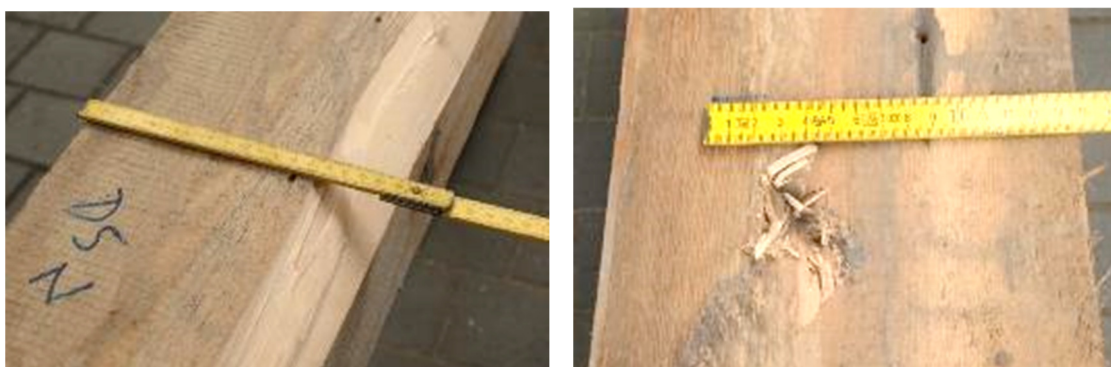
Abbildung 40: Ausbauschäden an Kantholz, die im Falle von S10 toleriert werden könnten
