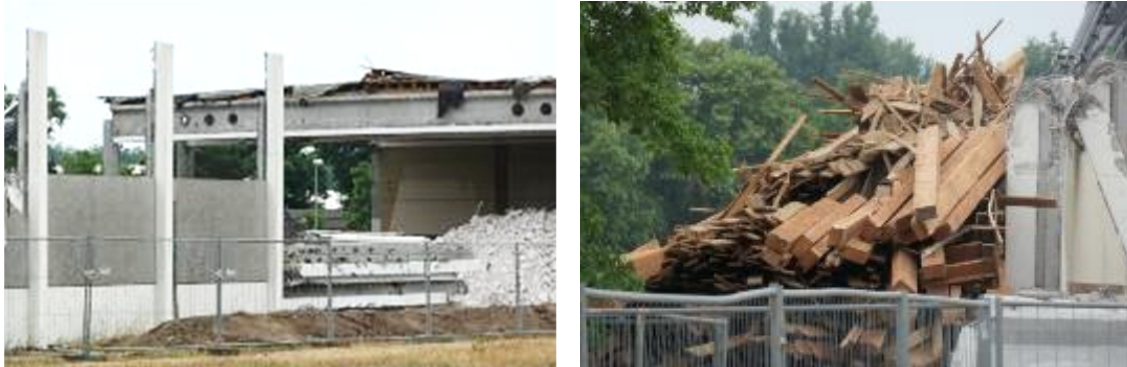
Abbildung 17: Sekundärbauteile aus Holz im Dachaufbau (links) und Lagerung während des selektiven Abbruchs (rechts)
