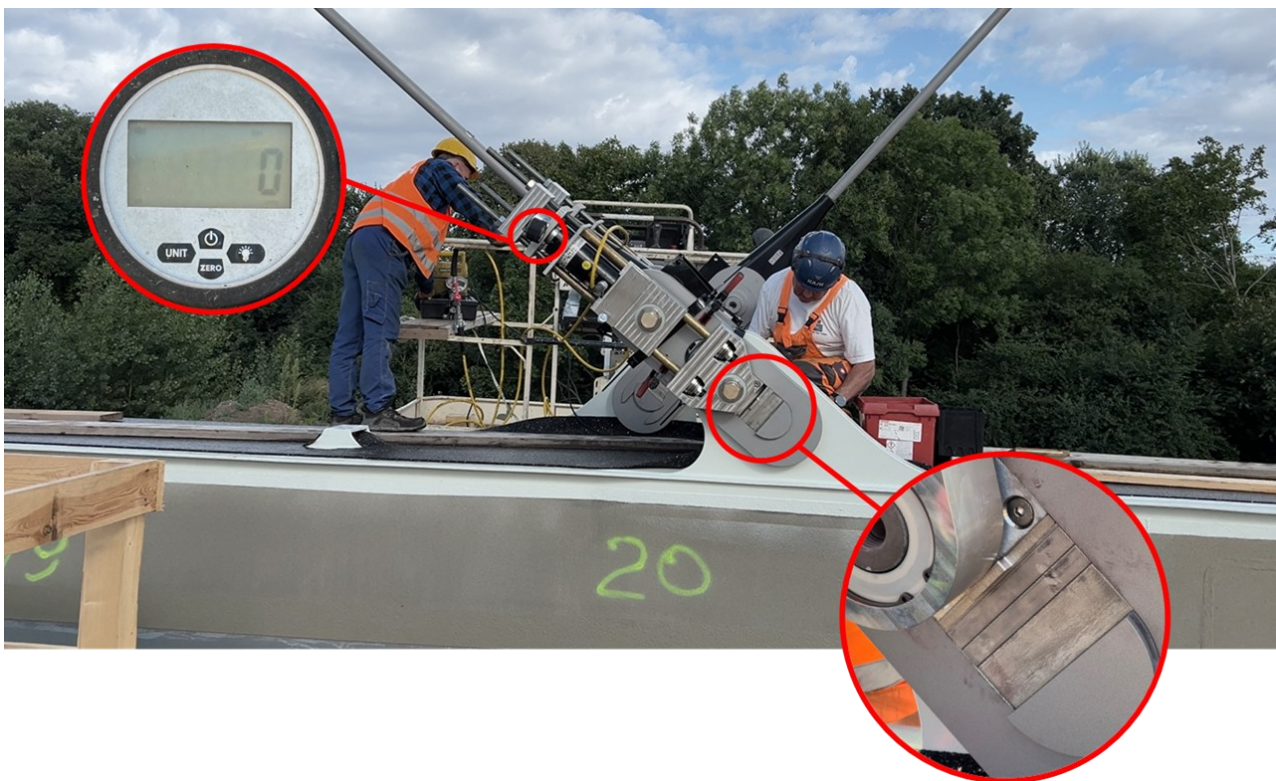
Abbildung 6-9 Spann- und Messvorrichtung mit hydraulischen Pressen und kalibrierten Kraftmessdosen zum Messen der Hängerkräfte und zum Spannen der Hänger der Oderbrücke Küstrin [L86], links: Detailansicht der Anzeige der Kraftmessdose, rechts: Detailansicht Futter zum Spannen.
