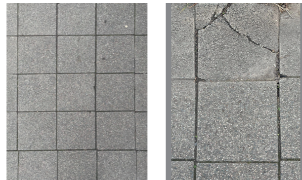
Abb. 44. Belagsmaterial Pflasterstein, mit verbormung des Belags & gesprungenem Stein an der Georg-Friedrich-Straße (K4)
