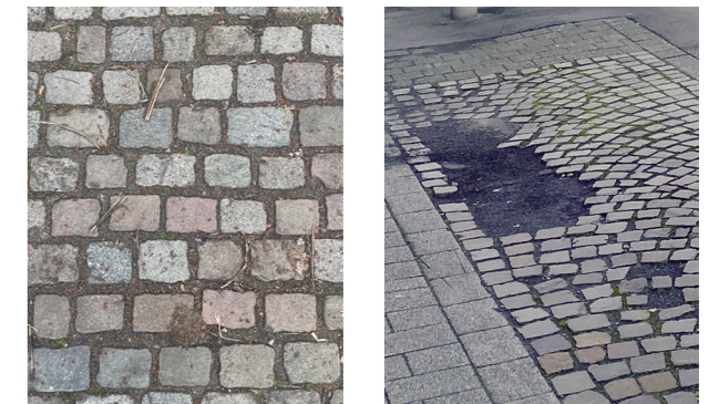
Abb. 46. Belagsmaterial Kopfsteinpflaster, provisorisch mit Asphalt ausgebessert an der Kreuzung Karl-Friedrich-Straße (K3)
