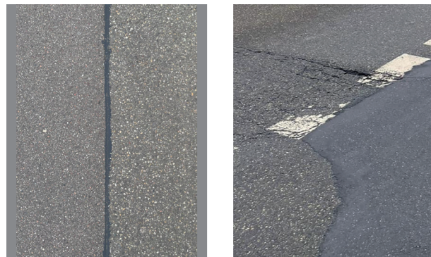
Abb. 43. Belagsmaterial Asphalt, mit typischen Schadensbild nahe Karl-Wilhelm-Platz
