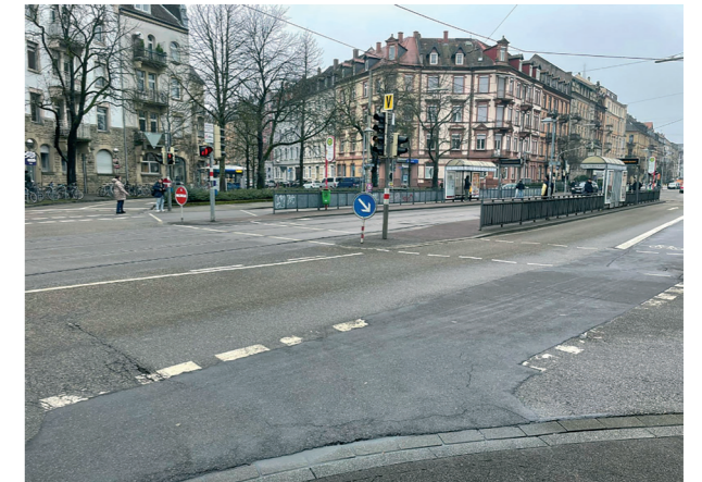
Abb. 49. K4 - Bodenbelagszustand Kreuzung Karl-Wilhelm-Straße
