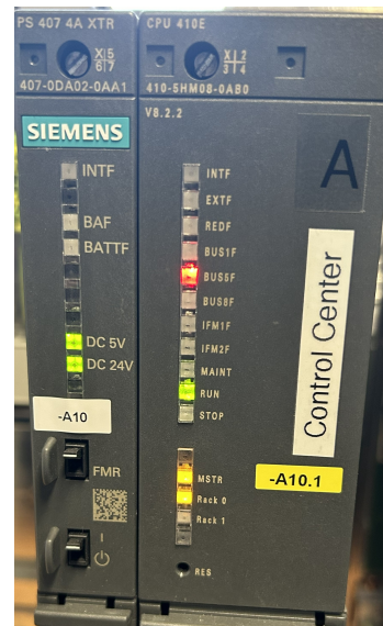
(d) S7-400 (Failure)
