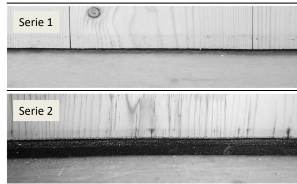
Abb. 4: Serie 1: schmaler Spalt zwischen Wand und Decke; Serie 2: Eine Schaumgummischicht zwischen Wand und Decke verhindert Zugluft
