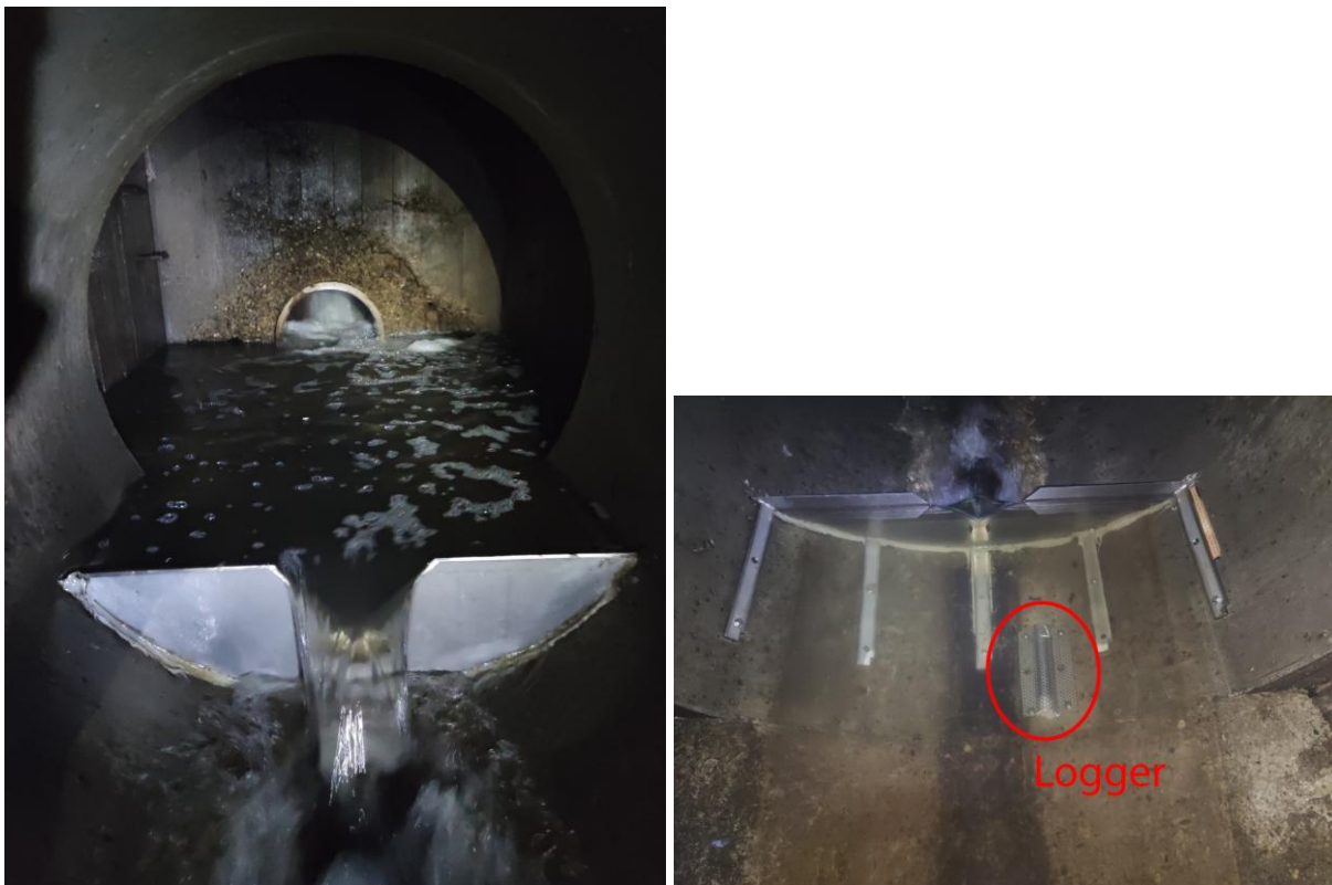
Abb. 20: Thomson-Messwehr: Frontansicht und Aufsicht mit separatem Drucklogger
