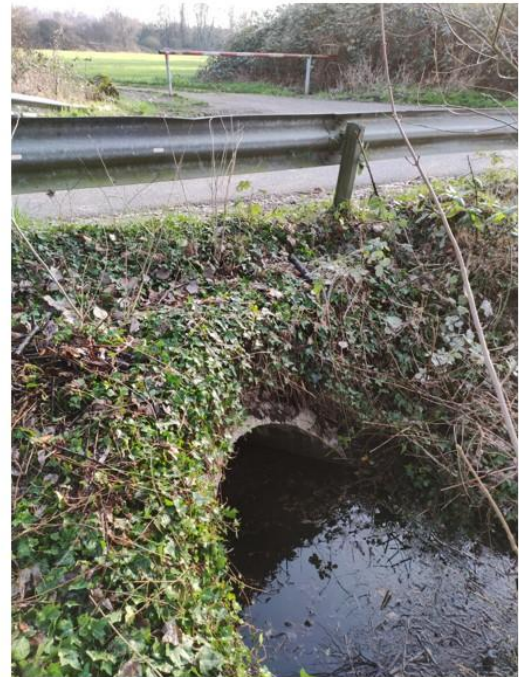
Durchlass Im Rheinfeld (DN 1500)
