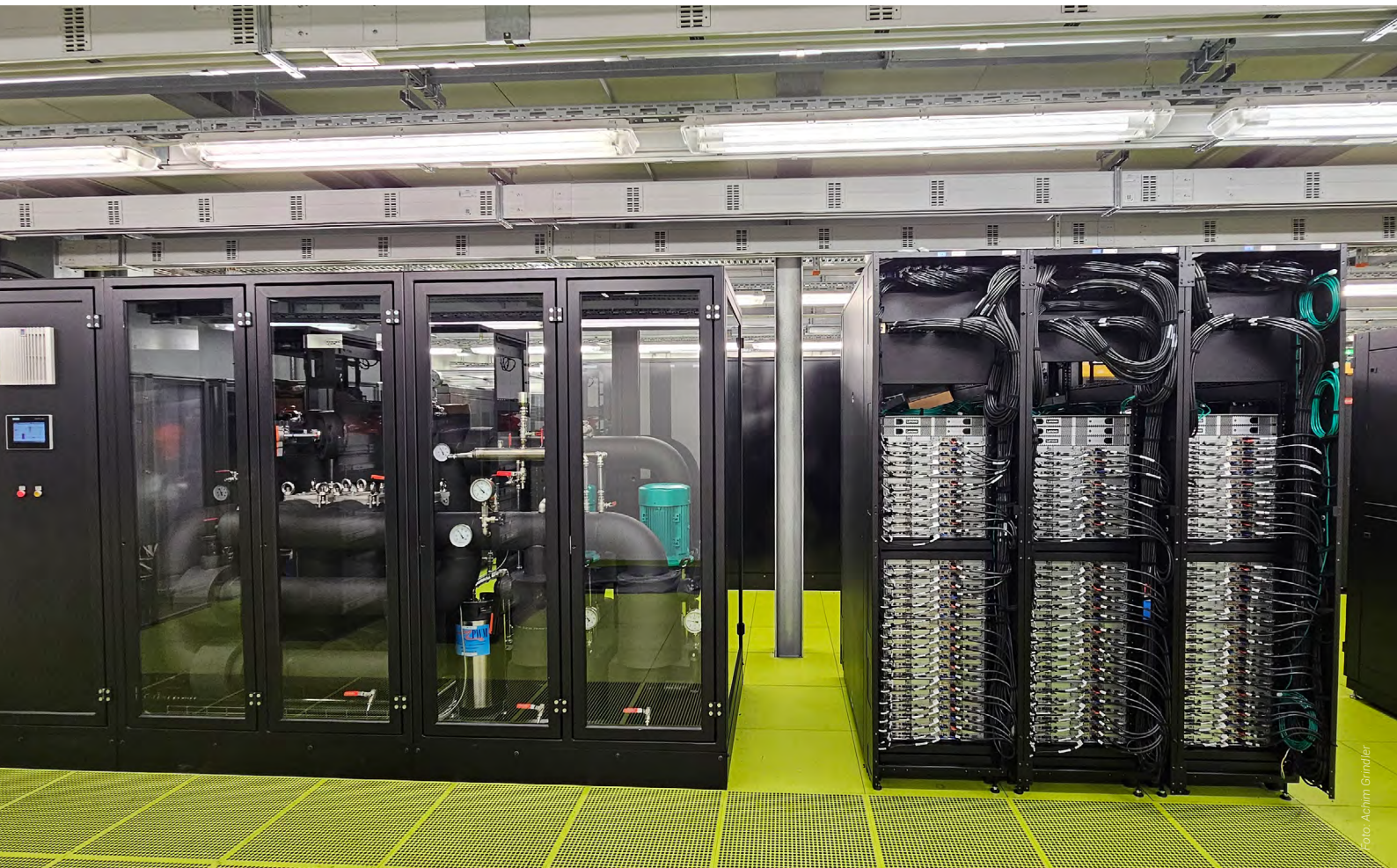
Abbildung 1: Blick auf die Kühlinfrastruktur und die ersten Racks des neuen Supercomputers HoreKa 2
