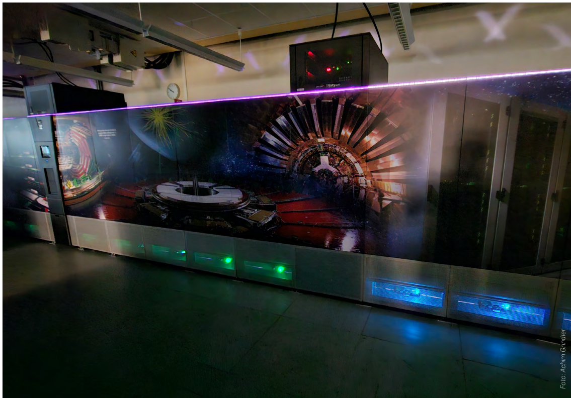
Abbildung 1: Blick auf einen Teil der Bandbibliothek im Rechenzentrum des SCC am KIT Campus Nord
