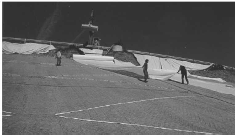
Bild 5.1.1.: Testfeld in Karlsruhe mit Sensorkabeln
