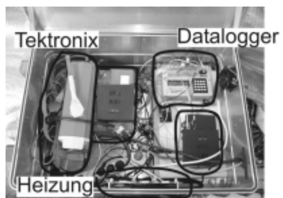
Bild 5.3.4.: Messgeräte in der Messbox
