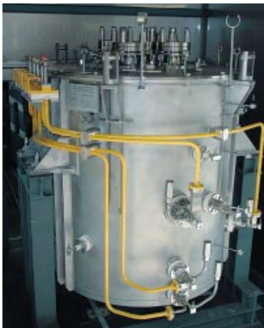
Abb. 5: Photo eines flüssig gespeisten keramischen Glasschmelzofens.
