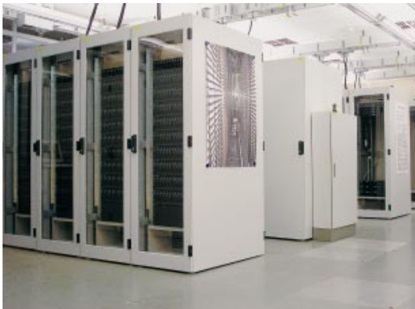
Abb. 1: Blick in das GridKa-Rechenzentrum.
