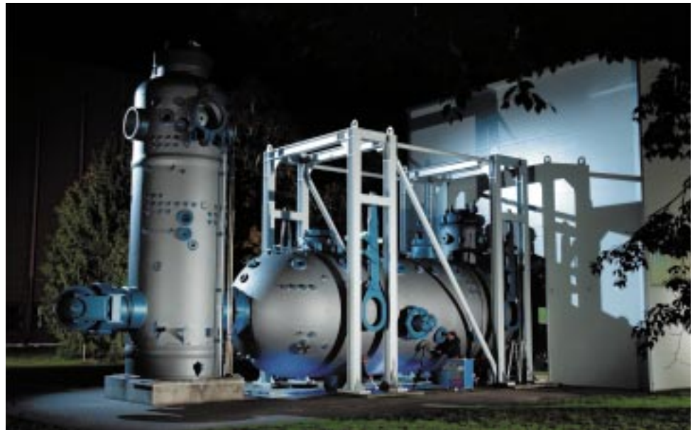
Abb. 7: Ansicht des Wasserstoffversuchszentrums mit einem liegenden Druckbehälter (110 m 3 , 100 bar), einem vertikalen Druckbehälter (30 m 3 , 60 bar) und einer Versuchskammer für H 2 -Verteilungsversuche (160 m 3 , in Halle, Abb. 5). Die Druckbehälter konnten vom Forschungszentrum Karlsruhe innerhalb einer HGF-Kooperation von GKSS übernommen werden.
