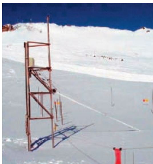
Abb. 4: Installation des TAUPE-Sensors für die Bestimmung von Schneefeuchte, Schneedicke und Schneewasseräquivalent (Messfeld Weissfluhjoch, Davos (CH)) zwischen einem Bodenanker und dem Turm. Die obere Befestigung muss höher liegen, als die maximal zu erwartende Schneedecke.
