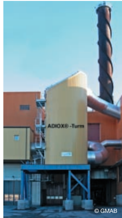
Abb. 7: Teilansicht der Rauchgasreinigung MVA Linköping,
