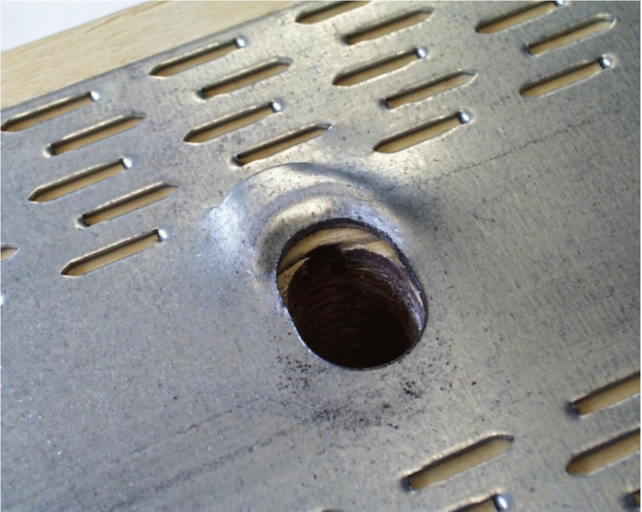
Bild 8: Verformung der Lochwand der Nagelplatte
