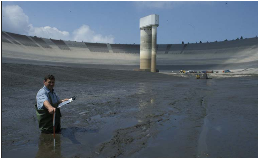
Abb.1.2: Schlammablagerung im Hornbergbecken vor Beginn der Umlagerungsarbeiten (s. Nestmann et al., 2002)
