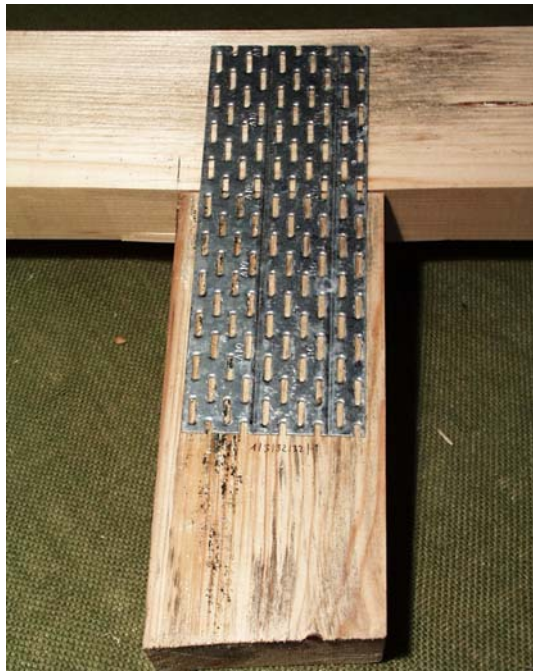
Bild 5: Beginnender Pilzbefall bei einer Feuchtekombination von (32%, 32%)
