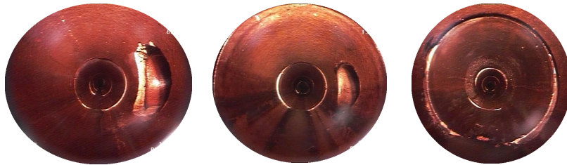
Abb. 6-37: Teststrecke Rastatt/Kastanienweg S4-S5. Bilder einer TV-Befahrung des IITB vom 13.08.2002. Links: Hausanschluss nicht fachgerecht eingebaut bei 7,8 m / 09:00. Mitte: Abzweig verschlossen bei 14,5 m / 09:00. Rechts: Muffe stark beschädigt bei 16,85 m.
