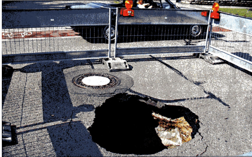
GEFÄHRLICHER ABGRUND: Riesige Mengen Kies wurden unter der Straße vor dem Waldfriedhof über einen defekten Schacht abgeschwemmt. Die Fahrbahndecke fiel zwei Meter in die Tiefe. Foto: Nestler
