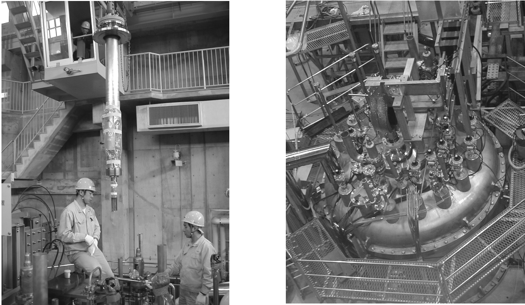
Abb. 6.4 Installation der 20 kA HTSL-SZF in den Kryostat (links) und Aufnahme des Kryostats und der Stromeinspeisungsschiene (rechts)
