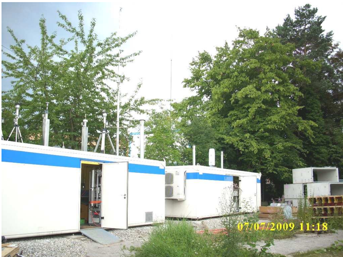
Abbildung 7: Messcontainer an der FH, Ceilometer mittig auf dem rechten Container. (Quelle: eigenes Foto, Jun. 2009)
