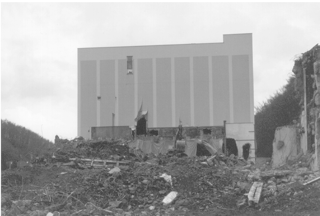
Abbildung 3-5 Hochlager mit davor aufgeschüttetem Fallbett
