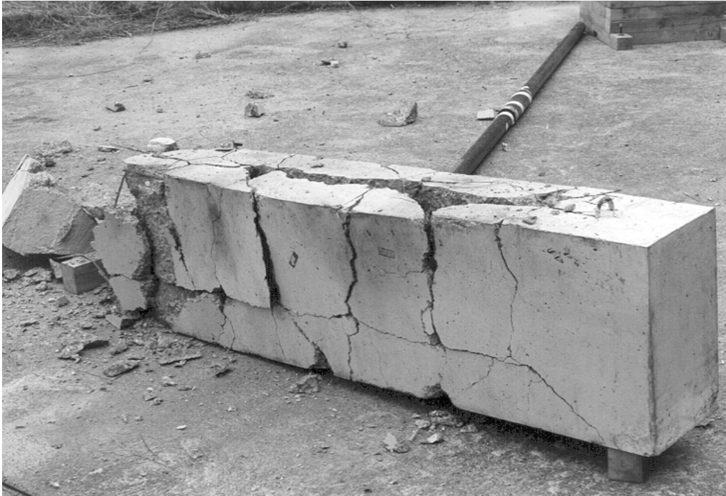
Abbildung I 21 Sprengergebnis Balken VK3, totale Zerstörung, Ansicht von der Gegenseite
