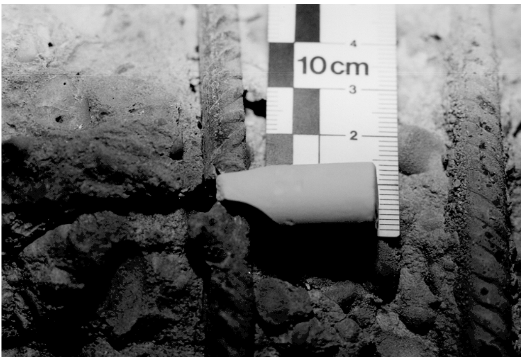
Abbildung K 14 gerissene Wendelbewehrung
