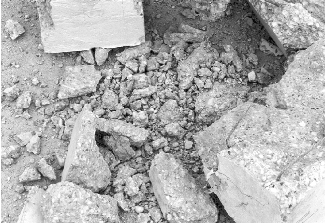
Abbildung I 29 Sprengergebnis Balken VK4, feinkörnige Fragmente als Haufwerk
