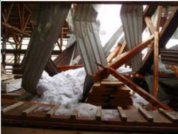
Abbildung 4: Schneedruck verursacht Hallendacheinsturz, Waldstatt 2006. (Quelle: Thomas Egli)
