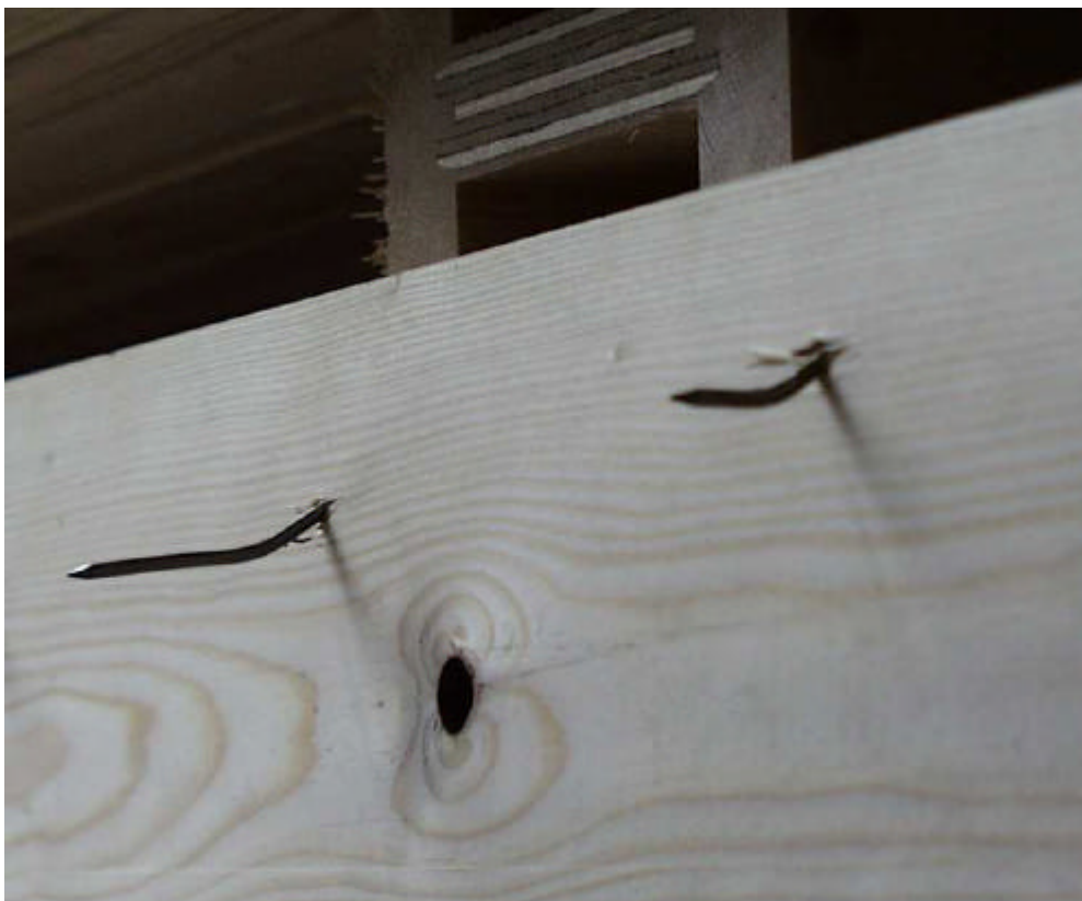
Bild D- 18 Deformierte Nägel, Detailaufnahme
