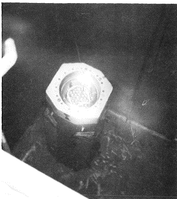
Abb. 7.1: Transportbehälter "TN1" beladen mit 44 Brennelementen im BE-Lagerbecken
