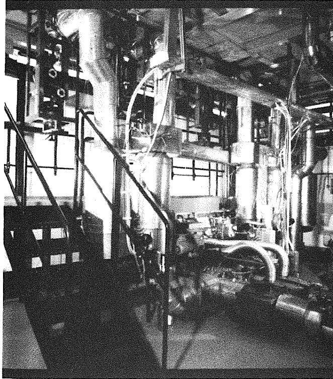
Bild 11: Natriumkreisläufe des IMF mit Pumpen, Wärmetauscher und Teststrecken (l.o.)
